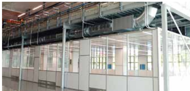
▲ Große Fenster und LED-Beleuchtung sorgen im 560 qm großen Reinraum Clean-Medi-Cell für viel Helligkeit.
